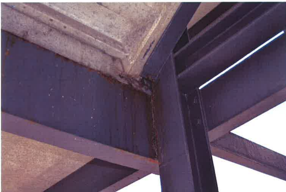
Foto 4: Corrosie in complexe aansluitingen in het trappenhuis (nabij spant 76)
