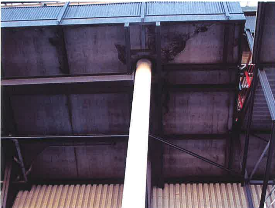
Foto 2: Watervoerende scheuren in bordes tussen twee trappenhuizen (nabij spant 4)
