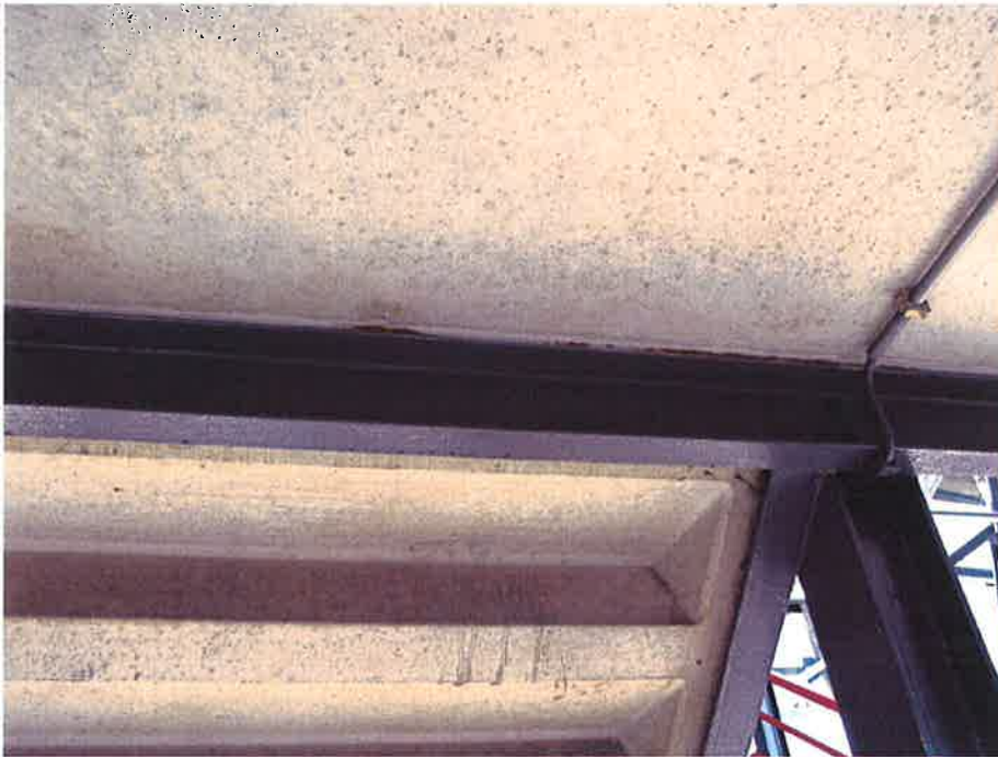
Foto 1: Corrosie van staalprofielen ter plaatse van oplegvlak van bordes (nabij spant 76)
