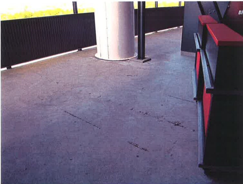
Foto 3: Wapeningscorrosie in de bovenzijde van bordes tussen twee trappenhuisen (nabij spant 113)
